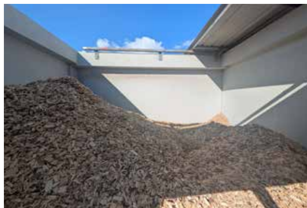
...und für ein großes Brennstofflager
