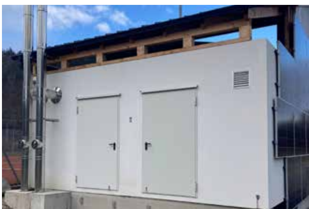
2 x 95 kW Hackschnitzelheizungen finden hier Platz
