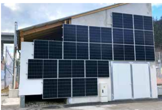
Die Heizbox (links integriert) beinhaltet die Kessel
